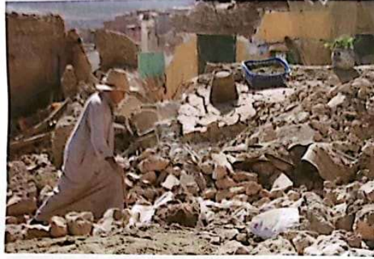
Après le tremblement de terre, il faudra un véritable plan Marshall pour reconstruire un toit pour les victimes. Ce qui nécessite de gros moyens financiers et matériels (Ph. Bziouat)
